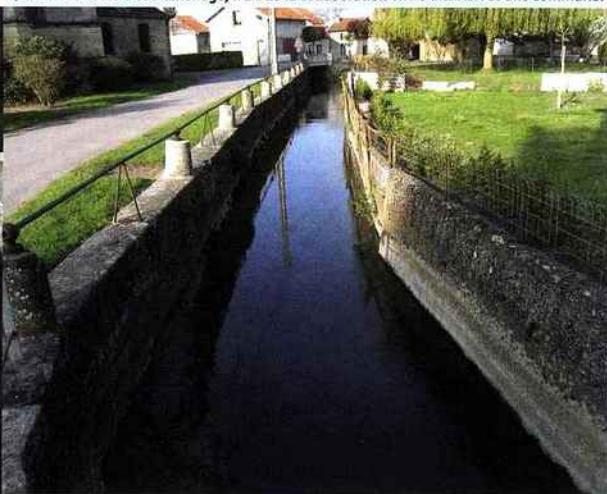
↓ Le même cours d'eau aménagé, fruit de la collaboration entre une ASA et une commune.
